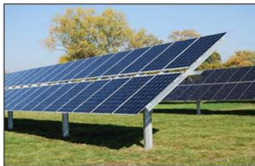
Figur 6: Solceller monteret på bevægelige stativer.
