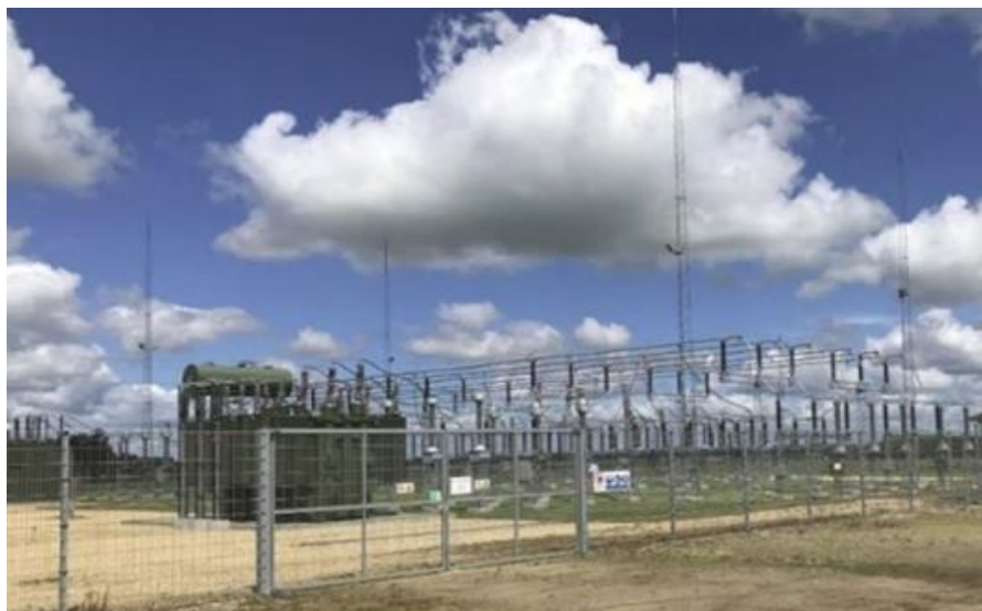
Figur 3-8 Eksempel på effekttransformer, lynafleder og tekniske konstruktioner
