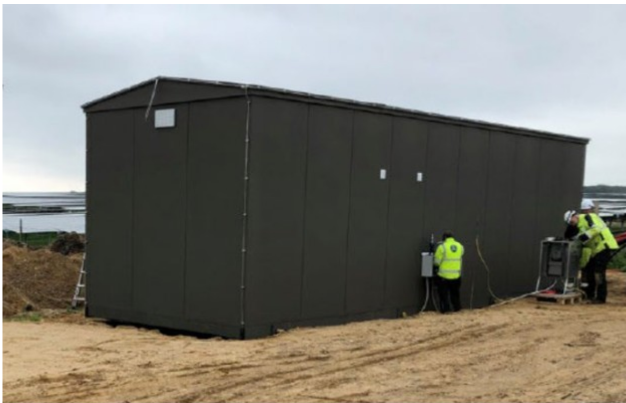
Foto 8 Eksempel på primær koblingsstation.
