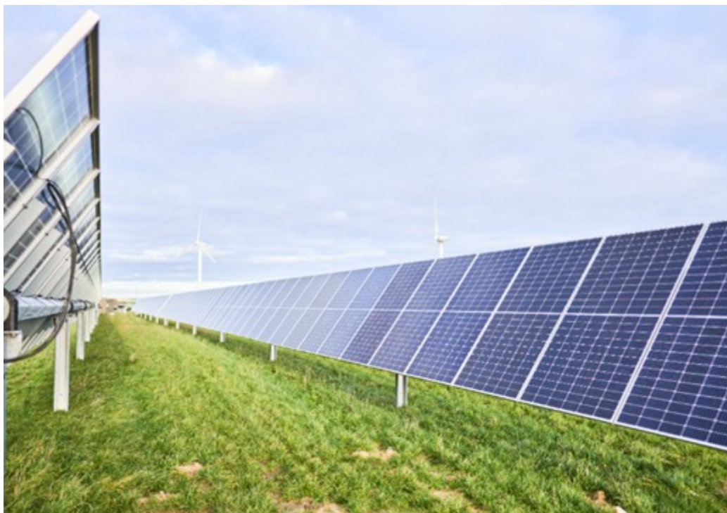
Foto 1: Eksempel på solcellepaneler med trackersystem
