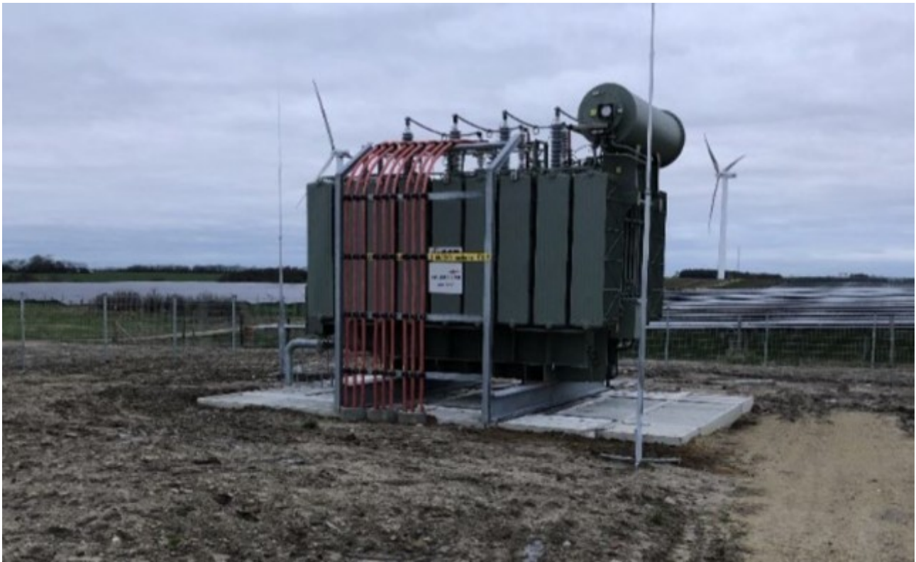
Foto 7: Eksempel på en effekttransformer og to lynafledere.
