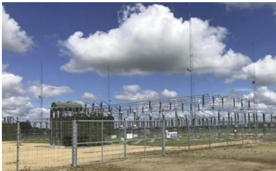
Figur 3-8 Eksempel på effekttransformer, lynafleder og tekniske konstruktioner
