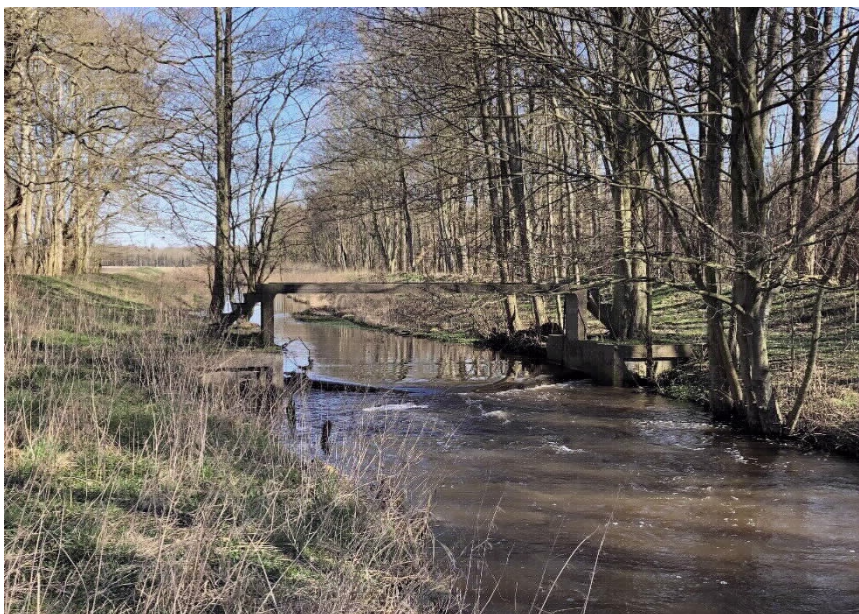
Figur 5-3 Spærring AAL-1553 Reguleringsbygværk v. høj vandstand.
