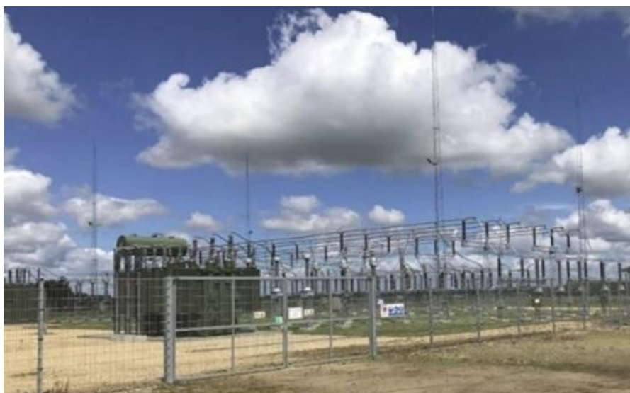
Figur 3-8 Eksempel på effekttransformer, lynafleder og tekniske konstruktioner
