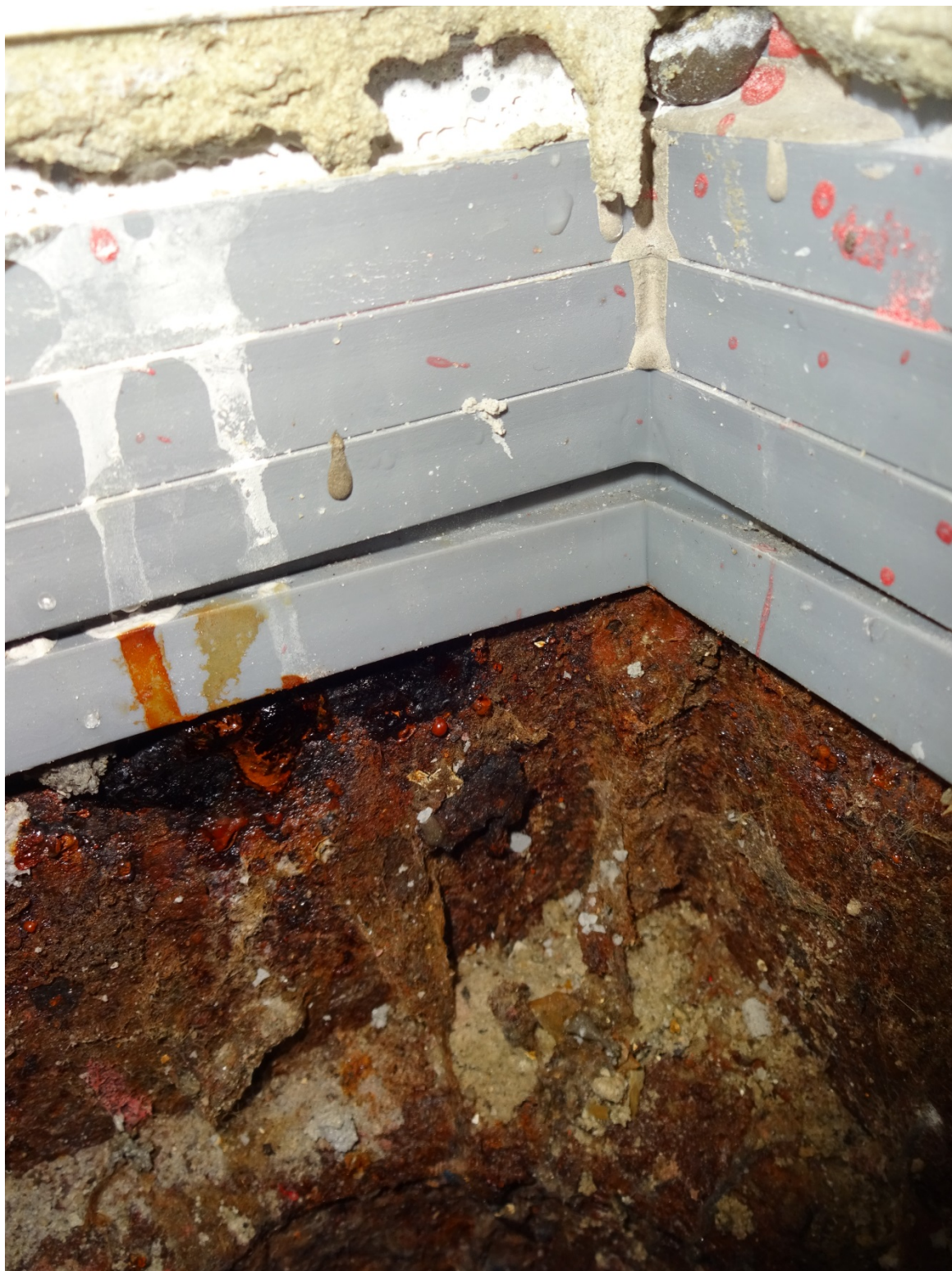
Gulvafløb i omklædningsrum i kælder forhøjet med forhøjerrammer med sprække mellem forhøjerrammerne.
