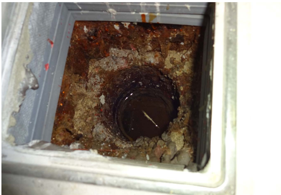
Gulv afløb i omklædningsrum i kælder forhøjet med forhøjerrammer.
