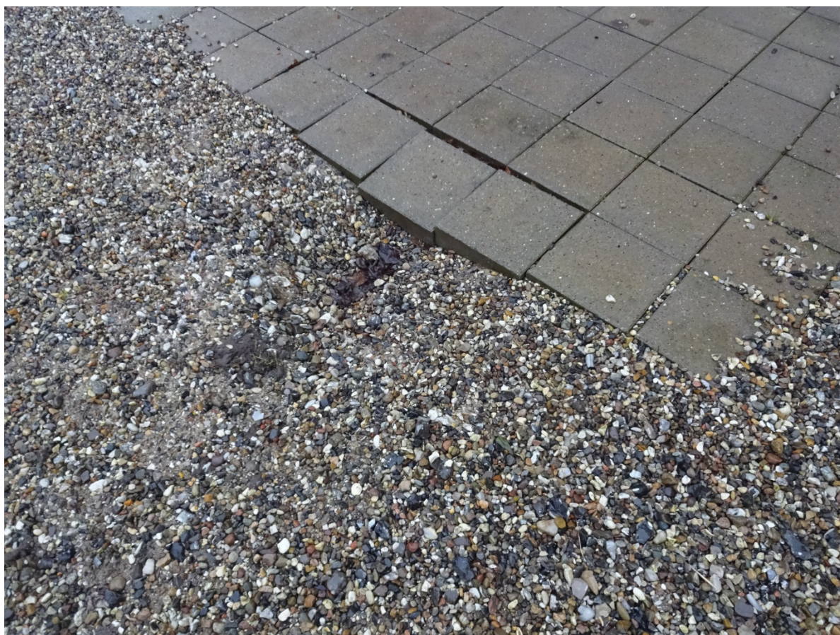
Østfacade, flisebelægning sunket pga. overfladevand
