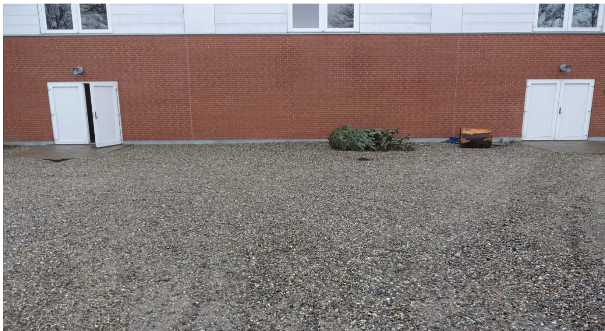
Østfacade, hvor der er problemer med overfladevand fra nabogrund
