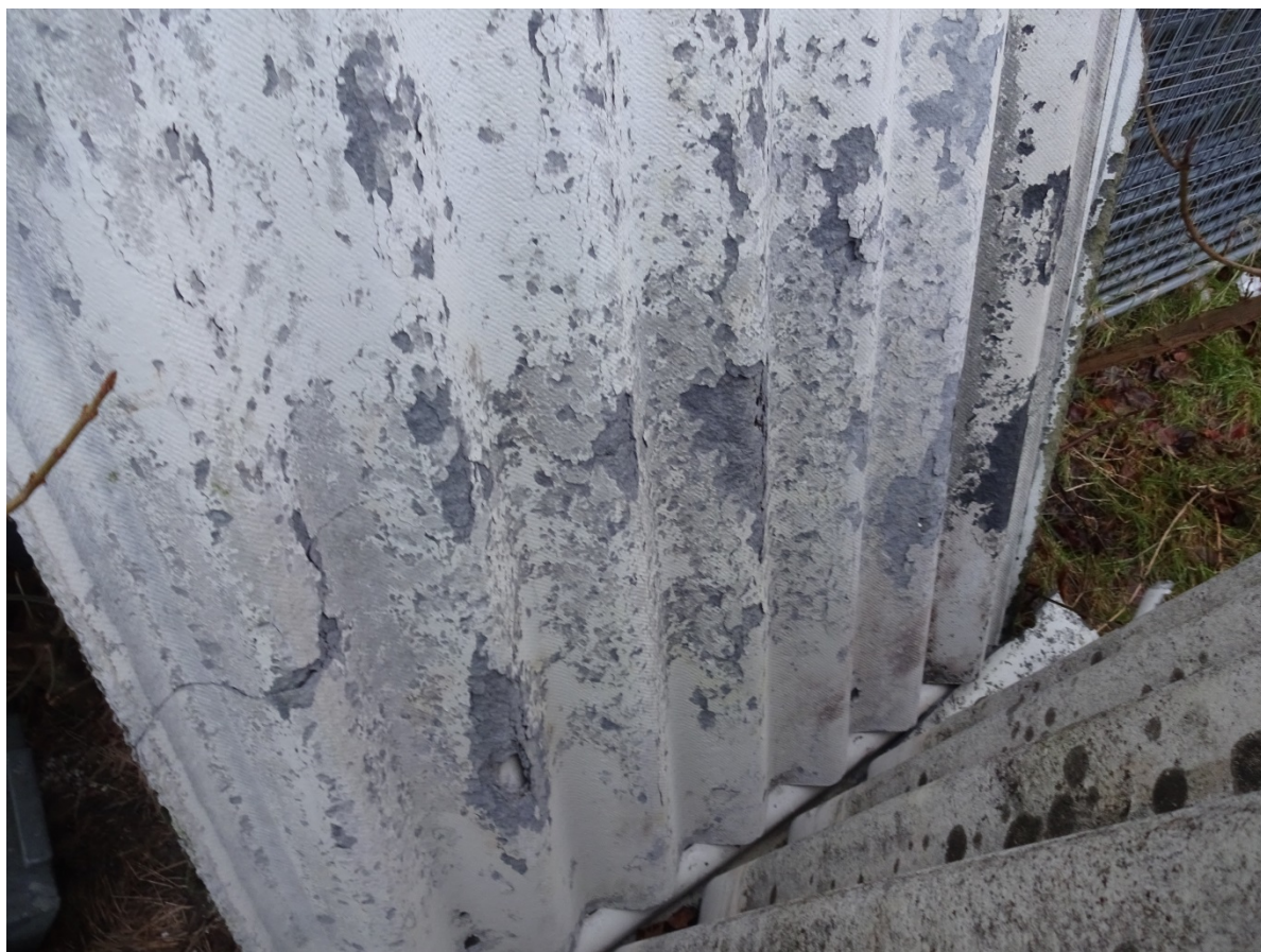
Nedtaget tagplade der smuldrer på indvendig side.
