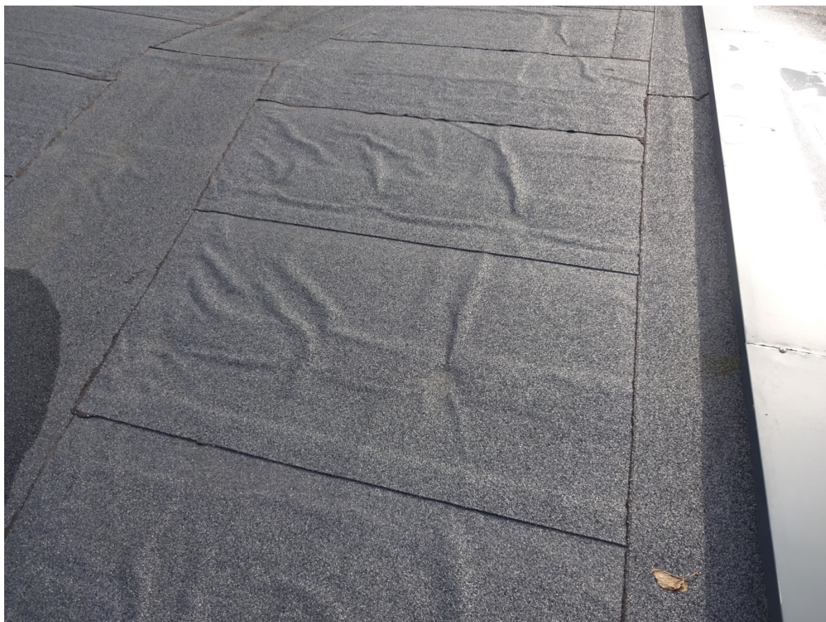
Dampbuler i tagpap over tilbygning til mødelokaler ved østfacaden.
