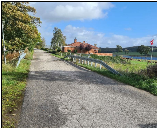
Eksisterende autoværn der ønskes forskønnet.
