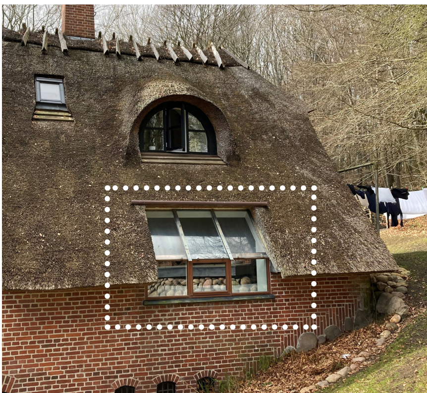
Vinduesløsning som ønskes udskiftet til nyt som eksisterende.
