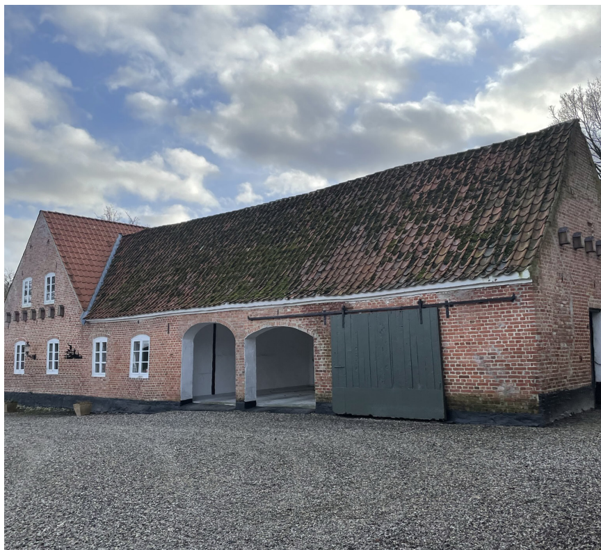
Bygningen set fra nord, som ønskes udskiftet til nyt udført som oprindeligt i dansk rød vingetegl.
