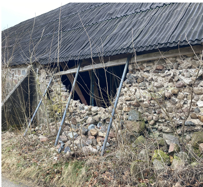
Nedstyrtning af kampestenmur på længens langside, som ønskes genopført som oprindeligt.
