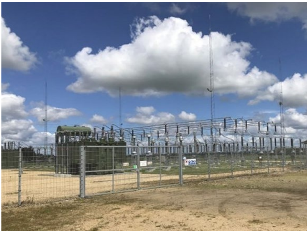
Figur 8 Eksempel på en transformerstation med effekttransformer tv. og tilhørende udendørs konstruktioner.
