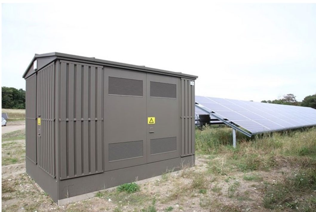
Figur 6 Foto af eksempel på teknikbygning. Her en typisk transformerkiosk, som indeholder en fordelingstransformer, eltavler, blæsere til afkøling, oliesump, niveaufølere, alarmer mv. Der etableres ca. en transformerkiosk per 3-4 MW installeret solcellekapacitet.
