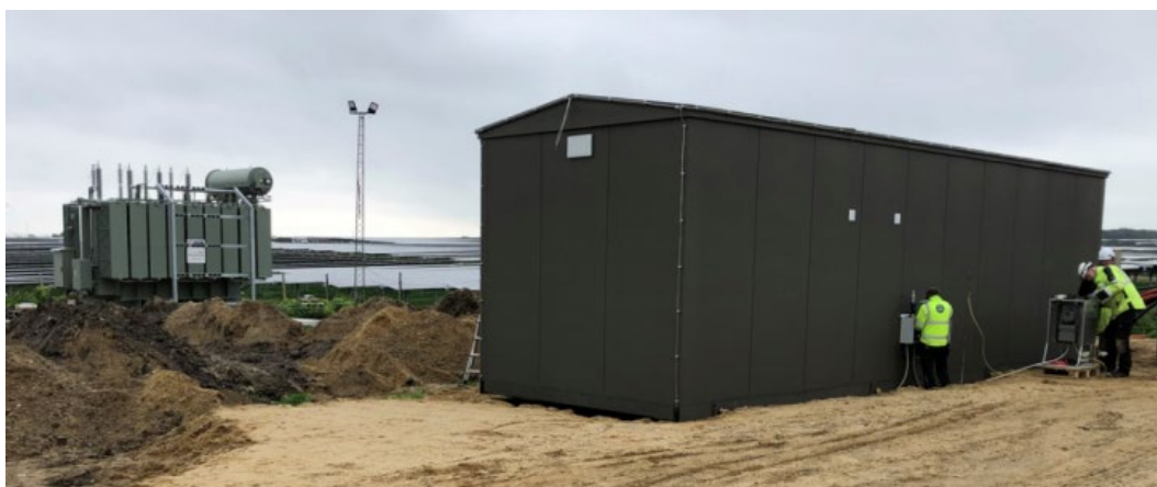
Figur 9 Eksempel på effekttransformer tv og primær koblingsstation th.
