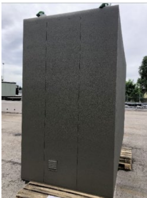
Figur 10 Eksempel på sekundær koblingsstation.
