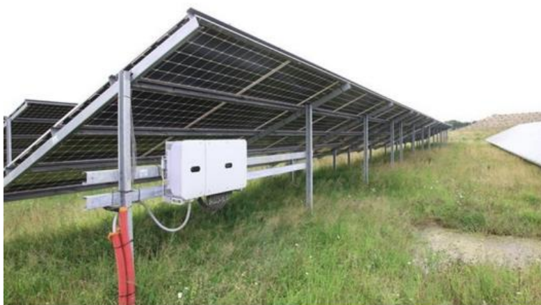
Figur 3-5 Eksempel på inverter (den hvide boks), som placeres under solcellerne. Inverterne omdanner jævnstrømmen til vekselstrøm af solcellepaneler på trackerstativer.
