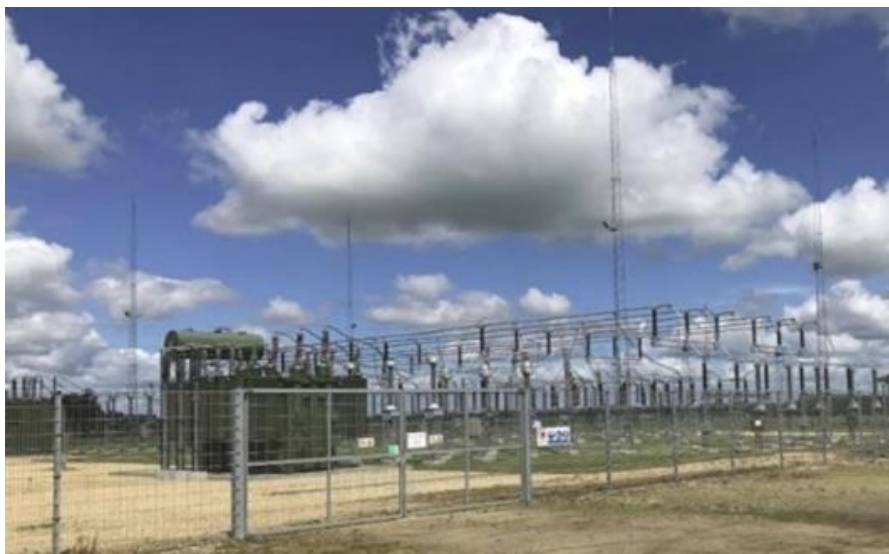
Figur 3-8 Eksempel på effekttransformer, lynafleder og tekniske konstruktioner
