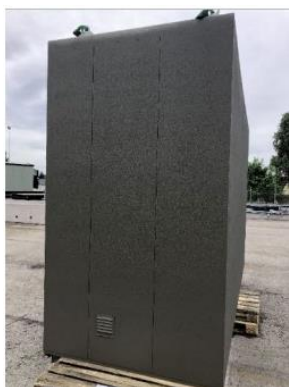
Figur 3-10 Eksempel på sekundær koblingsstation.
