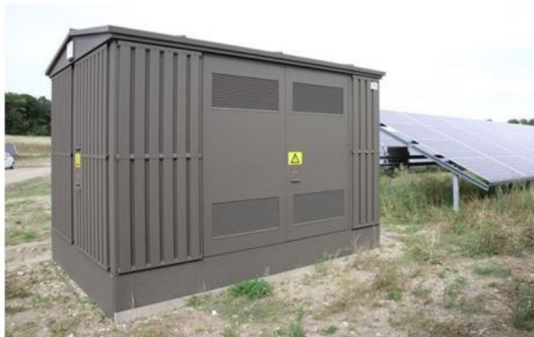
Figur 3-6 Eksempel på teknikbygning. Her en typisk transformerkiosk, som indeholder en fordelingstransformer, eltavler, blæsere til afkøling, oliesump, niveaufølere, alarmer mv. Der etableres ca. en transformerkiosk per 3-4 MW installeret solcellekapacitet
